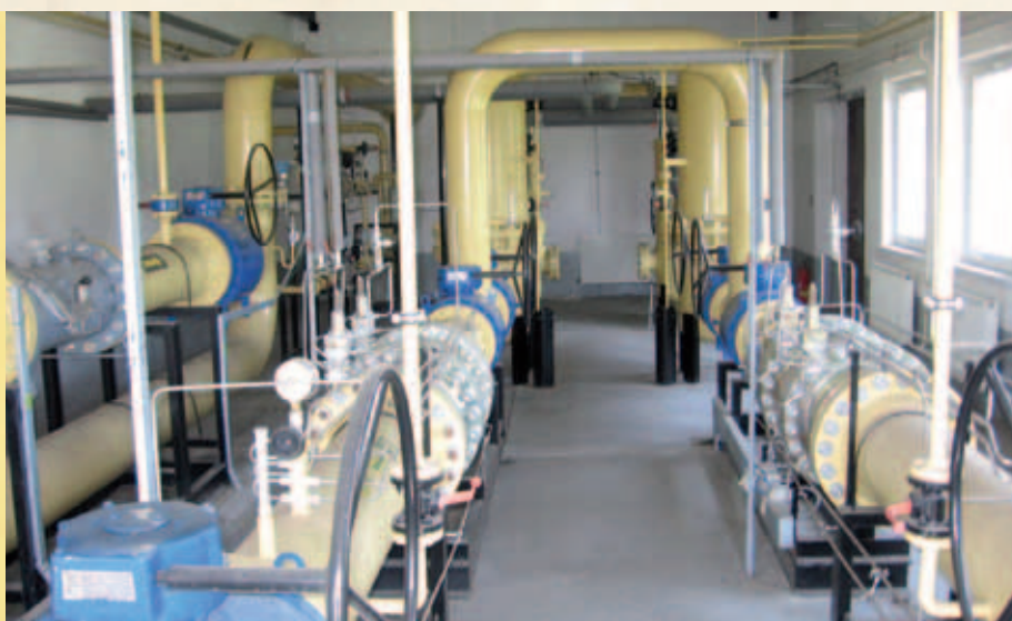
Technologické zariadenie prepúšťacej stanice v Záhorskej Bystrici – významný technologický objekt regulujúci tlakovú úroveň zemného plynu zo 4,0Pa na 2,5 MPa pre oblasť Bratislavu
